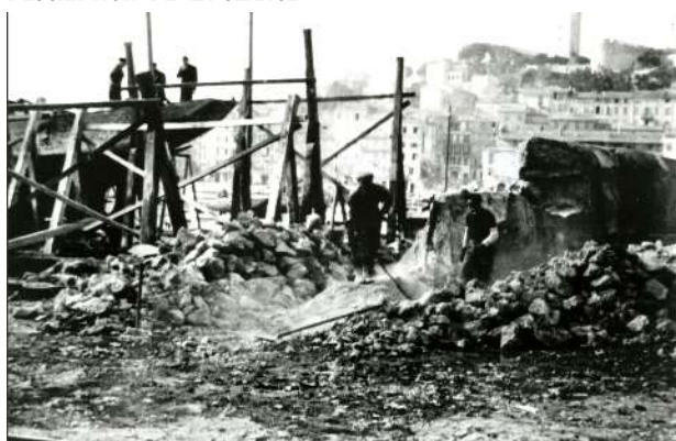
Démolition du mur construit par les Allemands sur la plage à la Libération 13Fi10
